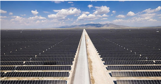
Şekil 3 - Güneş Enerjisi Santrali
