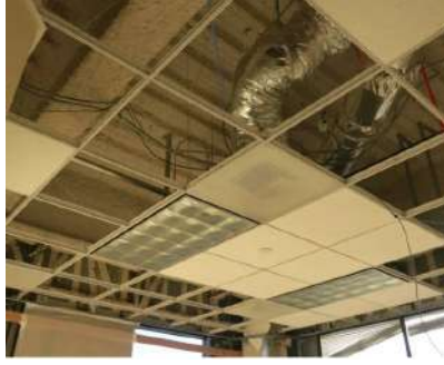
Şekil 3. Plenumda elektrik ve mekanik tesisat bileşenleri (URL-2)
