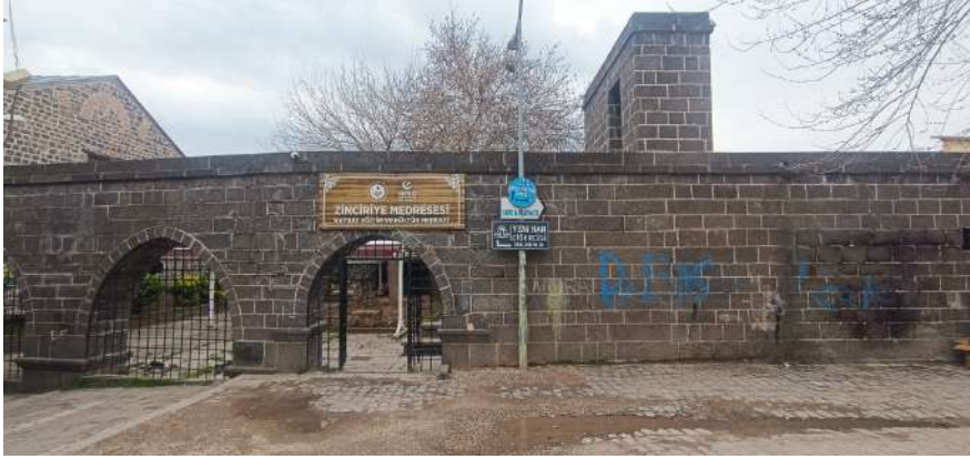
Şekil 10. Malzemelerde görülen kayıp ve bozulmalar.
