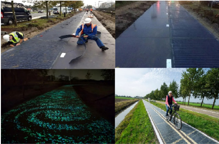
Şekil 2. SolaRoad Bisiklet yolunda kullanılan güneş enerji sistemi
